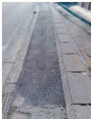
歩道の凹み舗装 (駅東)
